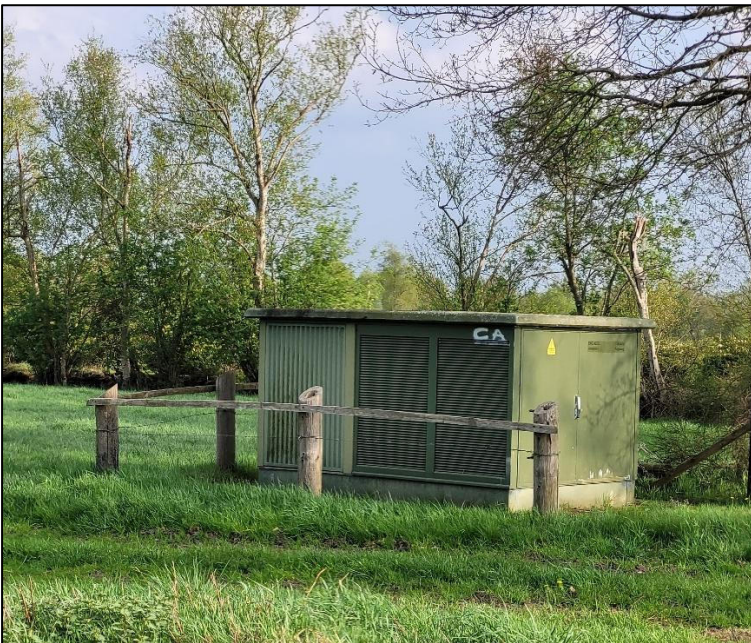
Abbildung 8: Sonstige Anlage zur Energieversorgung (OKZ). Foto: Looschen, April 2025.
